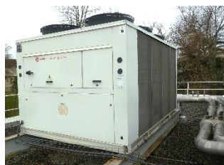
Production d'eau glacée
